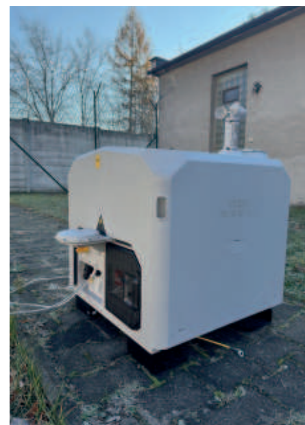
Věznice – dokovací stanice dronu
